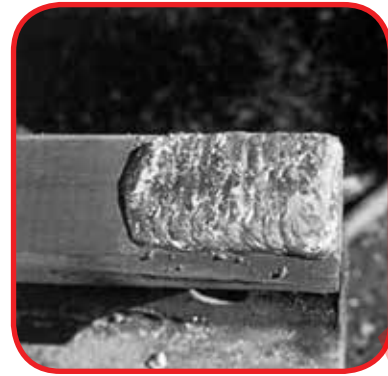
Figura 5 – RELLENO: extremo de riel desgastado, reconstruido por encima de sus dimensiones originales. Será rectificado antes de volver al servicio.
